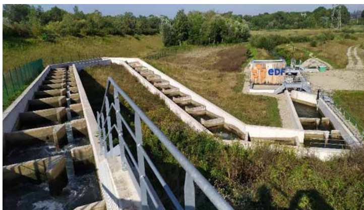
Équipement de la centrale hydroélectrique de Gerstheim sur le Rhin (67) © V. BURGUN –OFB
